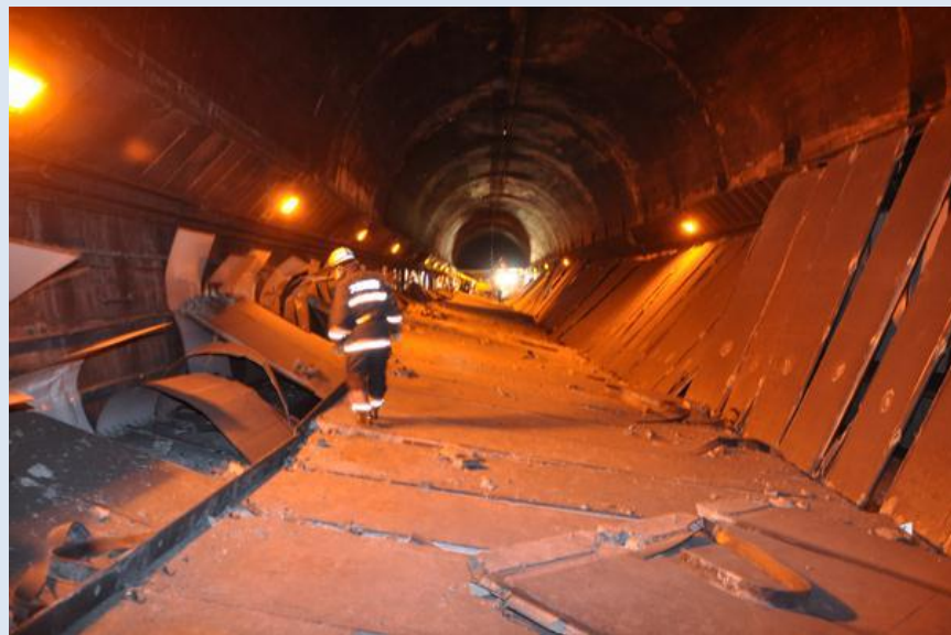
【笹子トンネル天井板崩落事故】 (平成24年12月2日発生)
