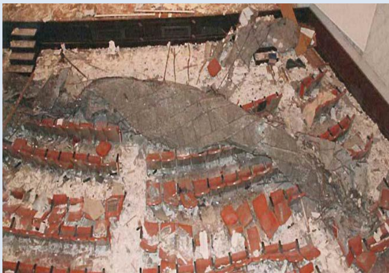
【九段会館天井崩落事故】 (平成23年3月11日発生)
