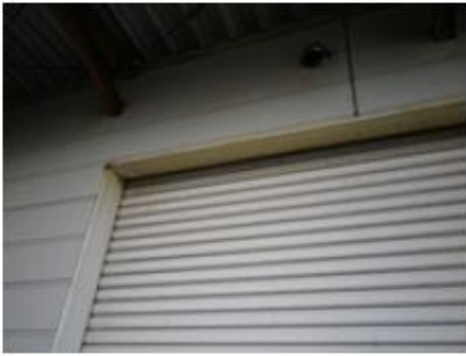
●シャッター及び格納部分の錆
