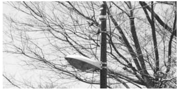
照度アップ！32Wの明るい街路灯
