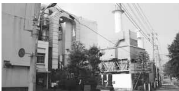
順次、焼却炉が停止されている二枚橋焼却場
