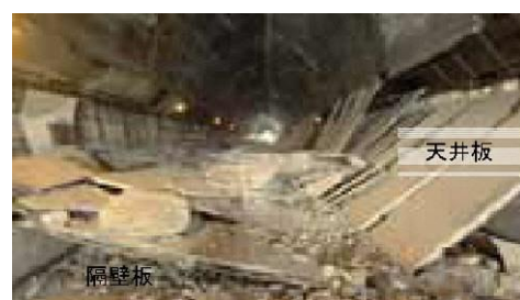
写真-4 天井板崩落状況②
