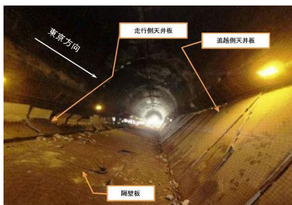
写真-3 天井板崩落状況①
