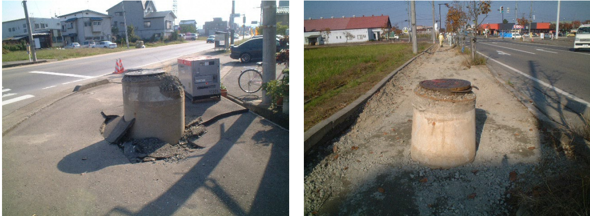
図4-5 マンホール浮上状況(2004年 新潟県中越地震)
