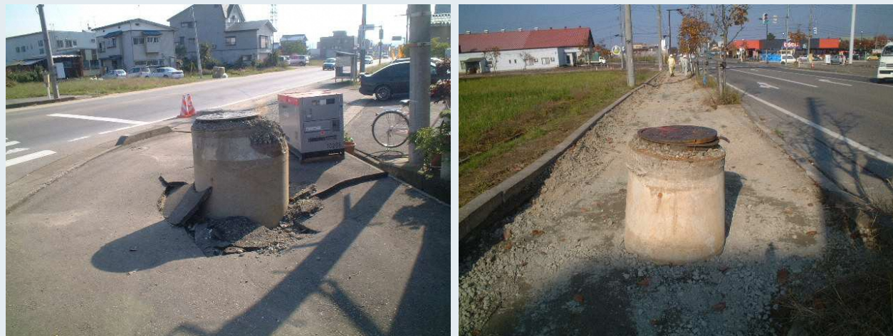
マンホール浮上状況例
