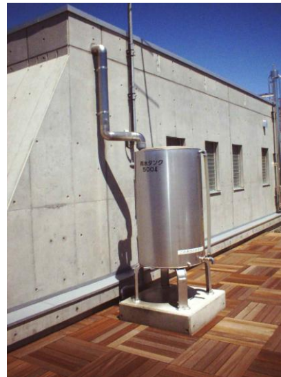
前原小貯留タンク
