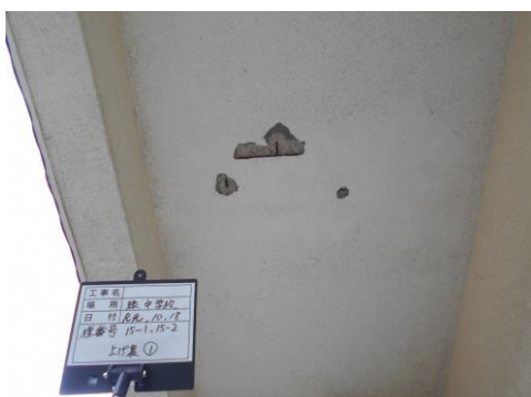
緑中学校 校舎・体育館(15-1、15-2棟) D評価 軒裏。外壁が剥がれ、鉄筋が露出している。
