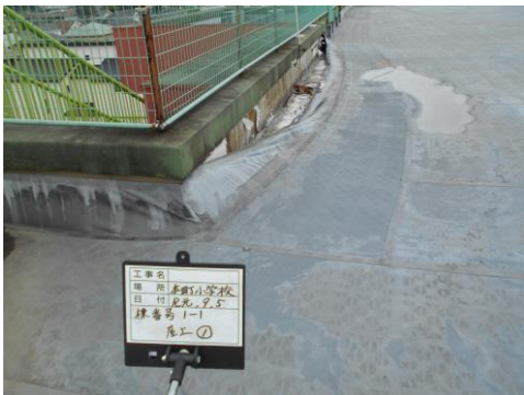
本町小学校 校舎(①-1棟) D評価 シートが破断してめくれしており、 12条点検で指摘されている。
