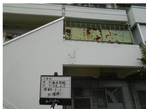
南中学校 校舎(1-1棟) C評価 外階段の金属部に錆がある。脆くなると、崩落して転落事故や落下事故に繋がる恐れがある。
