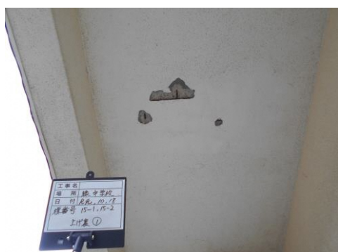
緑中学校 校舎・体育館(15-1、15-2棟) D評価 軒裏。外壁が剥がれ、鉄筋が露出している。
