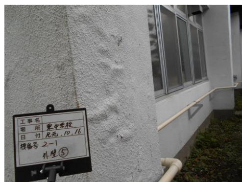
東中学校 校舎(2-1棟) D評価 外壁に浮きが見られる。また、この写真には写っていないが、亀裂も複数ある。
