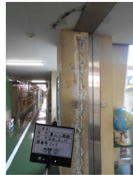
小金井第二小学校 校舎(①-1棟) D評価 防水層の剥がれ等があり、雨漏りが 内部にも影響を及ぼしている。
